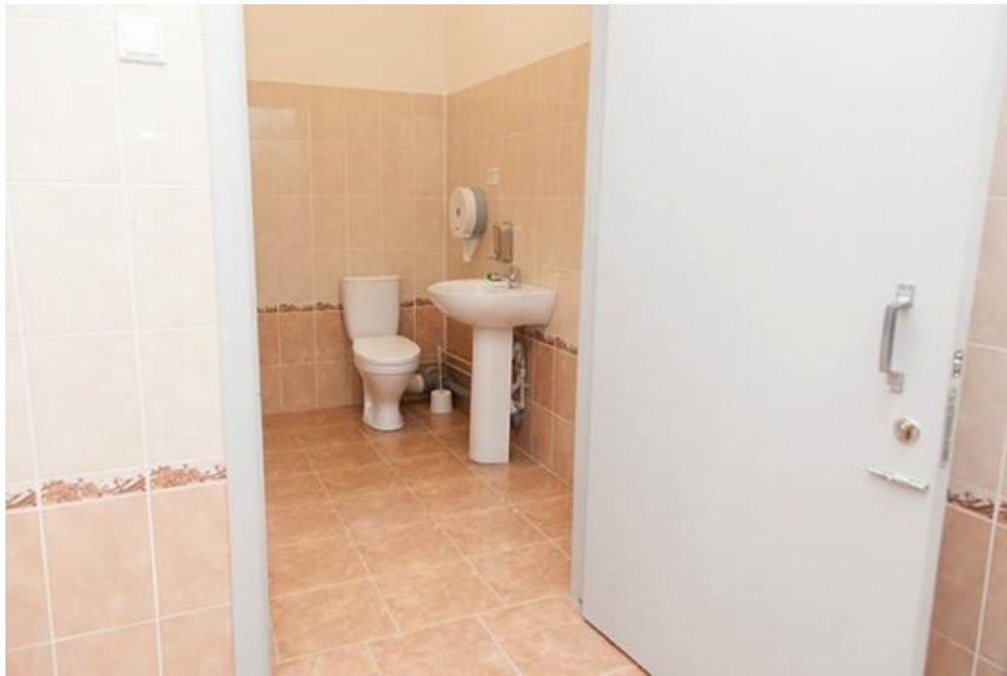
Оборудованный туалет в корпусе № 11
