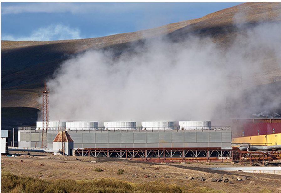
Мутновская Геотермальная электростанция Фото: Александр Пирагис / РИА Новости
